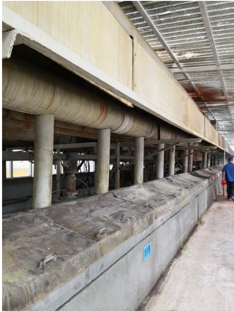
15 万 t/a 焊丝项目化镀生产线各槽密封并设集气管线
